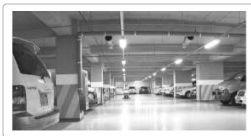
< 지하주차장 CCTV 및 조명 >
